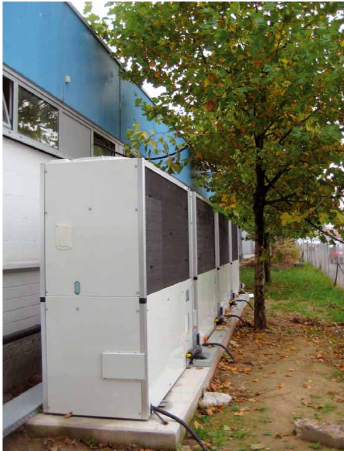
3 – AISIN VRF Gaswärmepumpenanlage, Luftkonditionierung über Kanalanschlussgeräte, Luftverteilung über Textilschläuche
